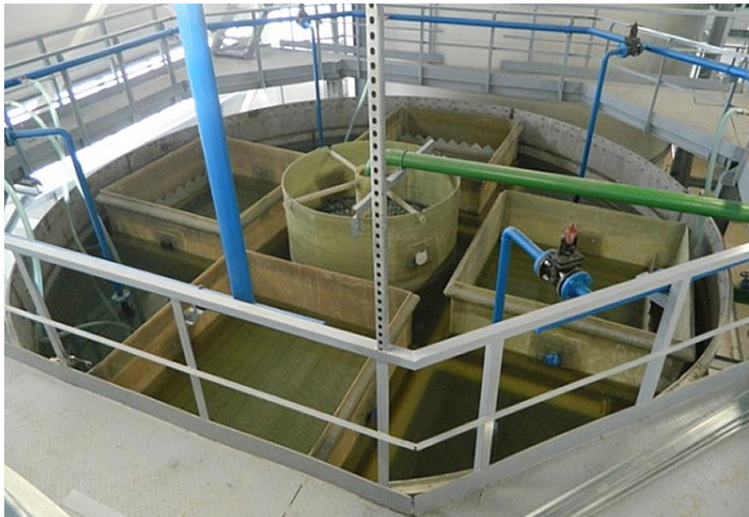
Рисунок 5 - Очистные сооружения серии «БИОТОК М»
